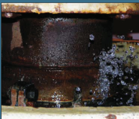
Les fuites entraînent la corrosion des équipements et la rupture prématurée des paliers
