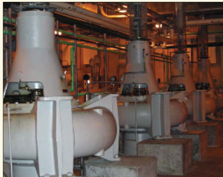
Ces pompes à effluents, dont l'étanchéité est assurée par des garnitures mécaniques en deux parties de 200 mm (8,00 po) de diamètre, sont en service depuis plus de 12 ans.
